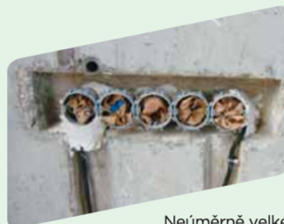
Neúměrně velké kapsy pro instalace
