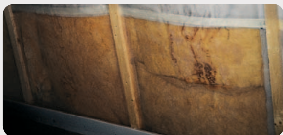
Poškození způsobené zabudováním vlhkého dřeva
