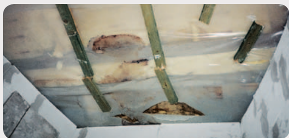
Poškození způsobené zkondenzovanou vodou
