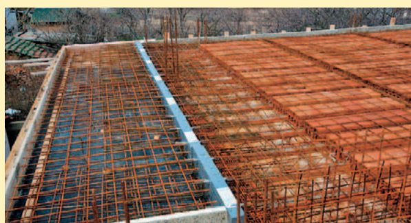
Přerušení tepelného mostu v rovině stropu pomůže zvýšit povrchovou teplotu podlahy a snížit riziko tvorby plísni.
