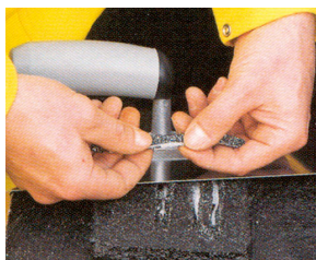
Kontrola stavu suchosti = kuličky EPS se musí dát přefříznout nožem. Tzn. dostatečná suchost stěrky pro aplikaci ochranných vrstev (nopová fólie, geotextilie, tepelná izolace) a následný zášyp zeminou. Zahrnutí nevyschlé bitumenové stěrky (kuličky EPS nelze přefříznout nožem) zeminou znamená mechanické poškození provedené hydroizolace.
