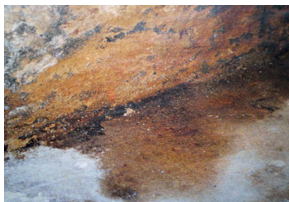
Odlupující se povrchové vrstvy z konstrukce.
