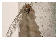
původní průsak vody
