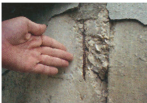
Nejprve je nutné provést průzkum poškozené konstrukce a vybrat správné materiály pro její opravu.
