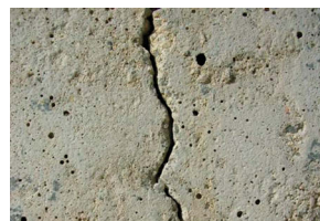
Svislá trhlina ve zdivu.
