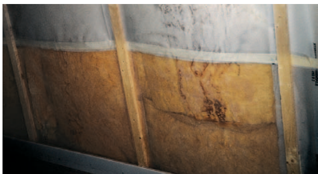
Poškození způsobené zabudováním vlhkého dřeva
