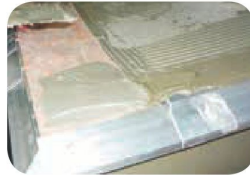
Nanesebí první a druhé vrstvy hydroizolační hmoty terizol po celé nášlapné ploše balkonového tělesa včetně bandáží, zubí ocel. hladítka 4x4 mm. Technologická přestávka min. 24 hod.
