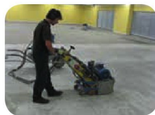
Na podlahách se používá metoda tryskání ocelovými kulíčkami, broušení nebo frézování. Na stěnách, pilířích a průvlacích je možno provádět tryskání pískem.
